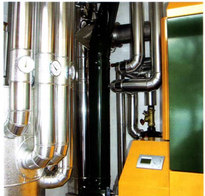
Die „Öko-Schau-Heizanlage“ – eine Investition für die Zukunft
